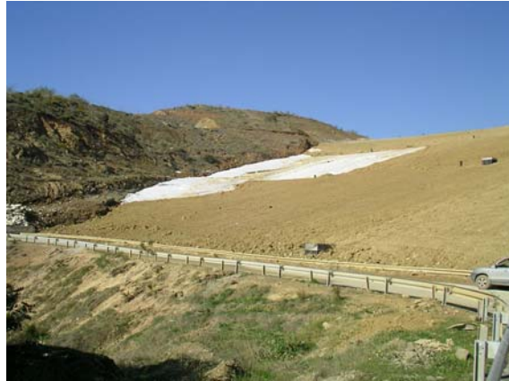
Foto 3. Colocación de geotextil y capa de cobertura para el sellado del talud Vertedero de RNP'S del Complejo Ambiental Los Ruices (Málaga).
