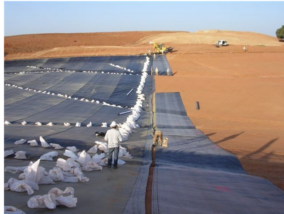
Foto 1. Instalación de geocompuesto bentonítico en el Vertedero de Aldeanueva de Figueroa (Salamanca)
