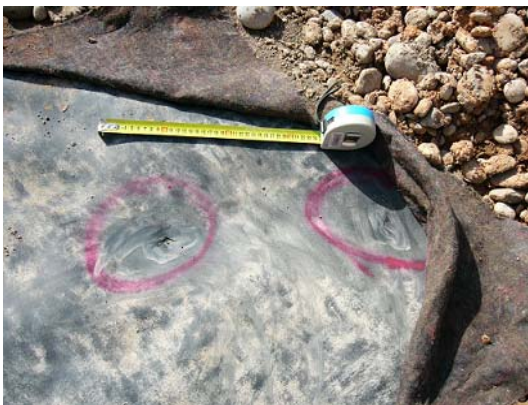
Fig. 13 Daño en la geomembrana, producido durante la instalación de la capa drenante
