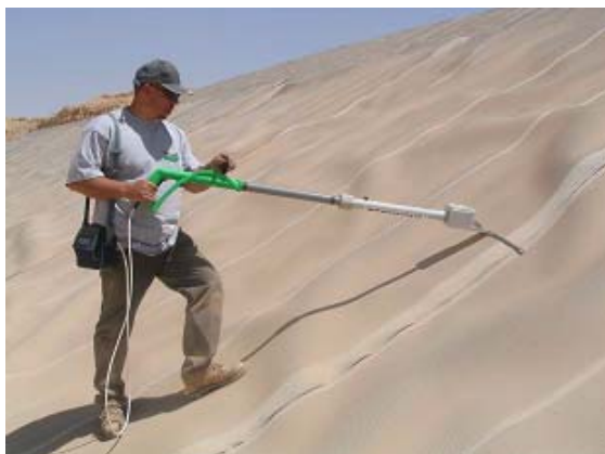
Fig. 17a El verificador de fugas en acción, sobre geomembranas descubiertas
