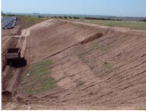
Fig. III 01. Talud con acabado deficiente
