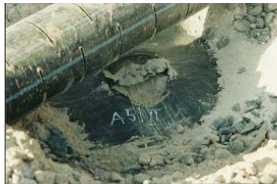
Fig. 14 Daño en la membrana, zona tubería de drenaje
